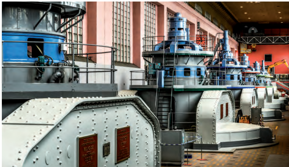
Salle des machines de la centrale hydroélectrique de Kembs (Alsace)
